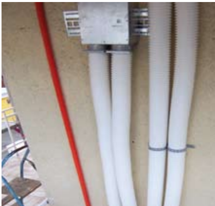
Luftdurchlassgehäuse TVA für Abluft mit Zehnder ComfoTube 75 entlang der Fassade
