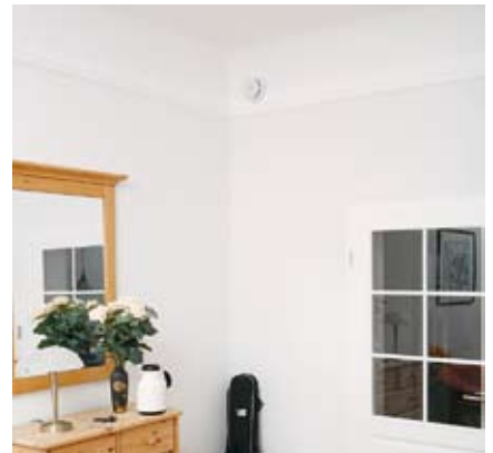
Endmontierter Wand-Luftdurchlass im Wohnzimmer
