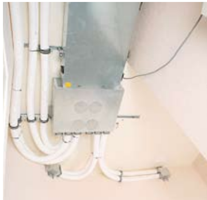
Lüftungsgerät Zehnder ComfoAir flat 150 innerhalb der später abgehängten Decke im Flur
