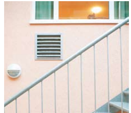
Fortluftöffnung der mechanischen Raumlüftung an der Außenfassade
