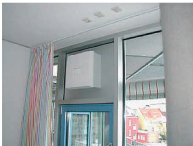
Lüftungsgerät M-WRG, Innenansicht
